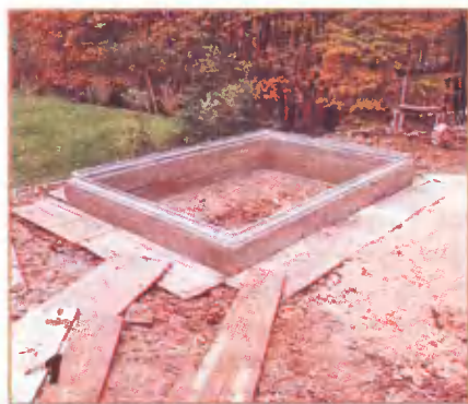
Ввиду того, что земельный участок имеет уклон, под теплицу возводят бетонный фундамент.
